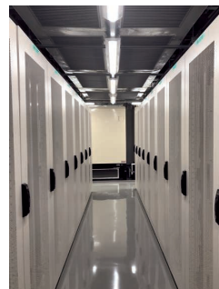
新大手町データセンターの 吹きおろし空調を備えたサーバ室
