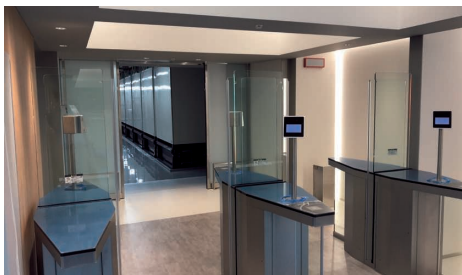
新大手町データセンターの顔認証付きセキュリティゲート
