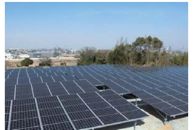
▲愛知県武豊町に新設した700kWの太陽光発電所
